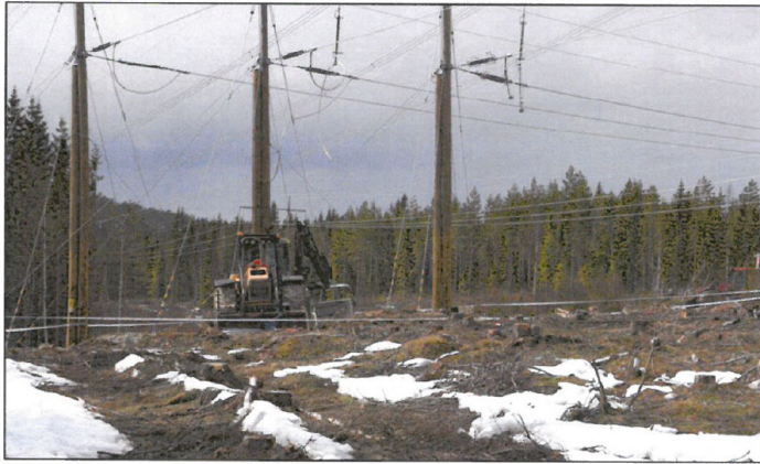
Figur 6. Stolprad 216. Den gula traktorn stod parkerad vid mittenstolpen. I luften kan man se två kablar som båda hänger löst i ena änden. Fotoriktnig åt väst.
